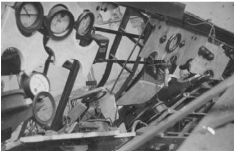
Posledice diverzije u električnoj centrali (mašinska kuća)
